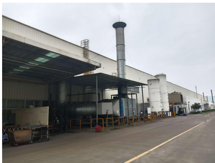
前纵梁及车架焊接线烟尘净化器
